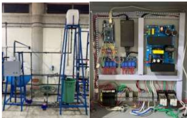
Figura 10 (a). Montaje del sistema de tuberías. (izquierda) Figura 10 (b). Instalación de componentes eléctricos. (derecha) Fuente: Fotografía tomada en el Laboratorio de Procesos de separación
