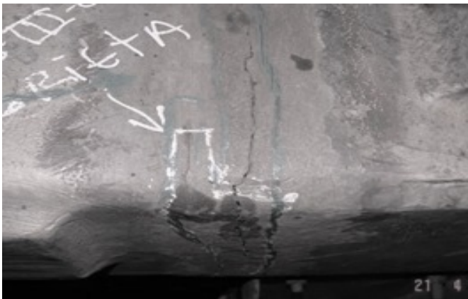
Figura 1. Grieta de 1000 mm en U, camión C327 - puente delantero. Fuente: Los autores
